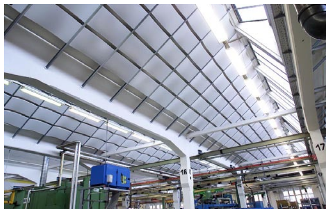
Panele dźwiękochłonne w hali fabrycznej
